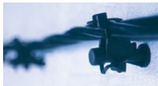
DPS25 Instalación con conductor de acometida
